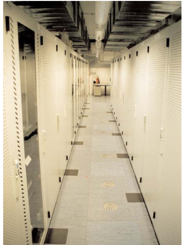
Rechenzentrum von NORD/LB. Raritan ermöglicht den direkten, sicheren Zugriff auf alle Server.
